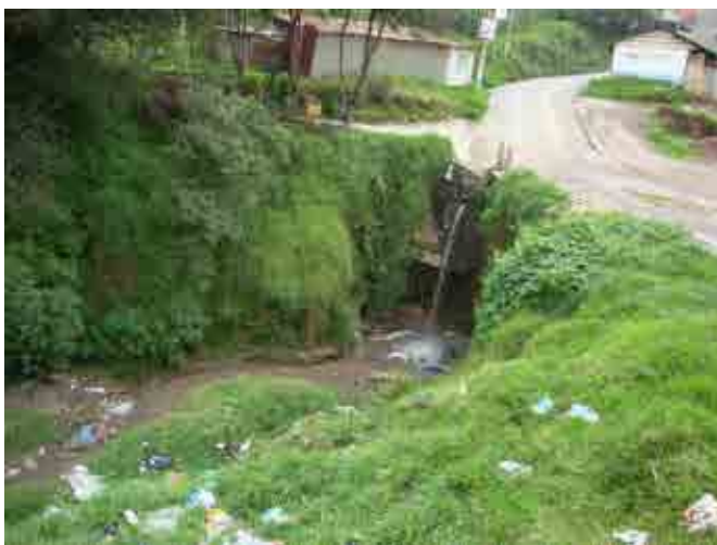
Imagen 14: Descargas de drenajes sobre cuerpos de agua sin tratamiento
