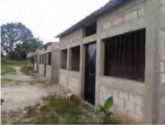
Fotografía 5 Viviendas sociales, sin urbanizar
